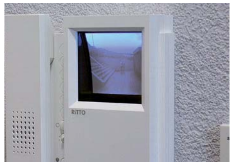
Abbildung 14: Durch die Überwachung der Zugangstür wird verhindert, dass Unbefugten Zutritt zum Kundenzentrum gewährt wird.
