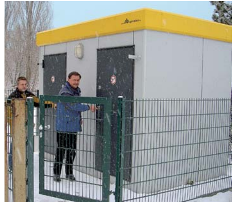
Abbildung 2: Durch Zäune kann deutlich gemacht werden, dass die Anlagen nicht frei zugänglich sind. Die Übersichtlichkeit bleibt gewahrt.
