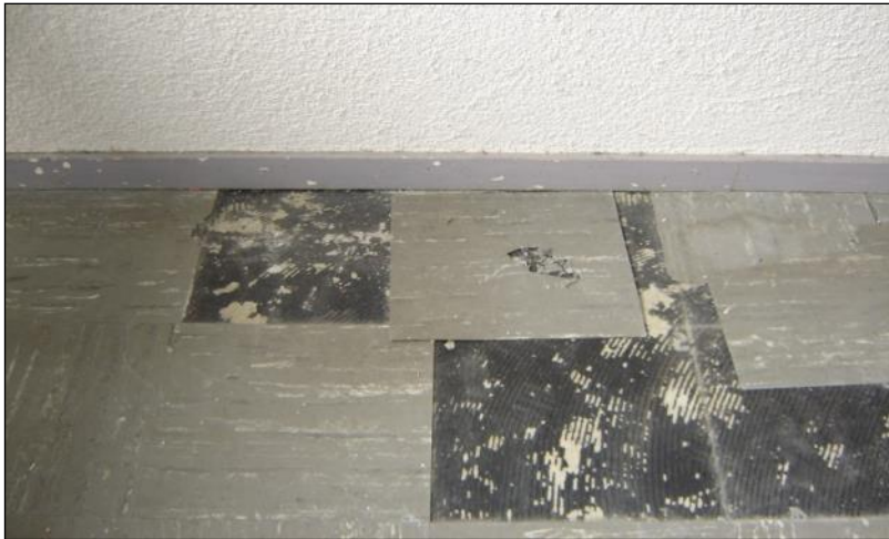
Asbesthaltiger Bodenbelag und Kleber
