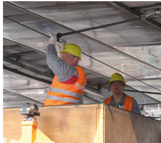
Abbildung 6: Nur mit isolierendem Brückenschutz ist das Arbeiten an der eingeschalteten Oberleitung unter Brücken erlaubt.
