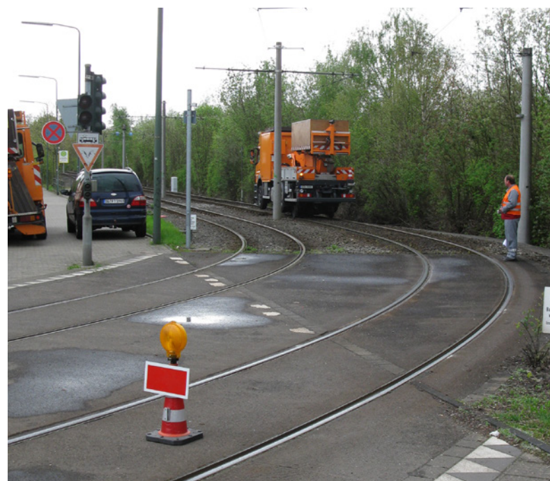
Abbildung 8: Bei Arbeiten im Gleisbereich kann der Arbeitsbereich durch ein in das Gleis gestelltes Schutzhaltsignal (Sh 2) vorübergehend gesperrt werden. Bei Annäherung eines Fahrzeuges wird das Schutzhaltsignal herausgenommen, wenn die Hubarbeitsbühne aus dem Gleisbereich entfernt ist.
