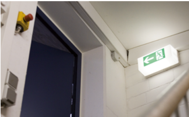
Kennzeichnung von Fluchtwegen und Notausgängen
