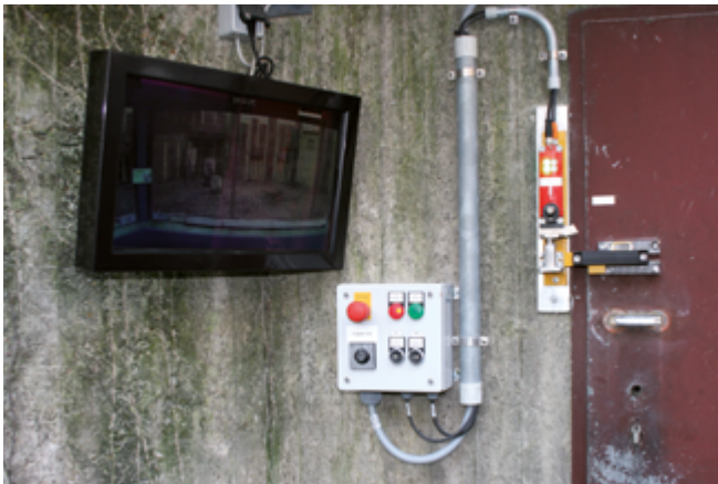
Bedienungs- und Verriegelungseinheit am Zugang eines Außengeheges (Stahltür mit dahinterliegender Gehegetür)
