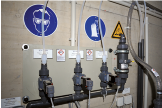
Wasseraufbereitungsanlage – mit aktuellen Gefahrstoffsymbolen, Gebotszeichen zur Verwendung von Persönlicher Schutzausrüstung sowie den erforderlichen Warnzeichen
