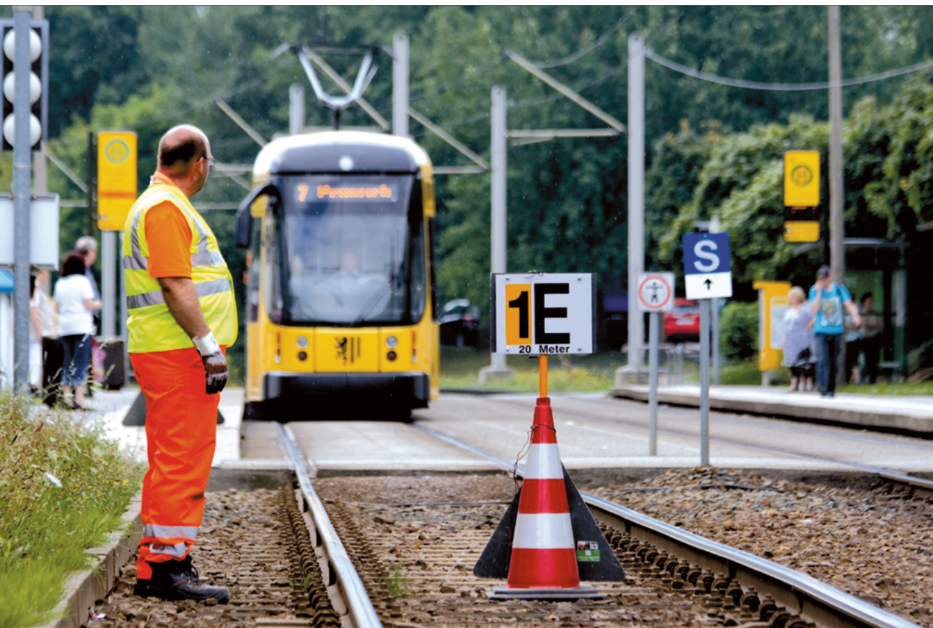
Abbildung 23: Durch die gelbe Warnweste wird dem Straßenbahnfahrer signalisiert, dass der Posten eine Aufgabe im Zusammenhang mit der festgelegten Sicherungsmaßnahme übernimmt.
