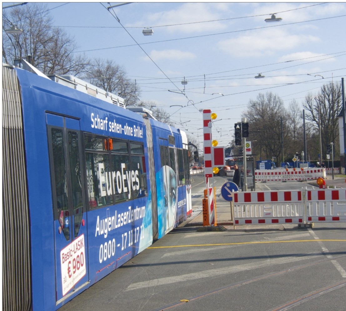
Abbildung 12: Die Straßenbahnschranke wird in diesem Beispiel automatisch angesteuert und verhindert das Einfahren des Individualverkehrs in den Streckenabschnitt.
