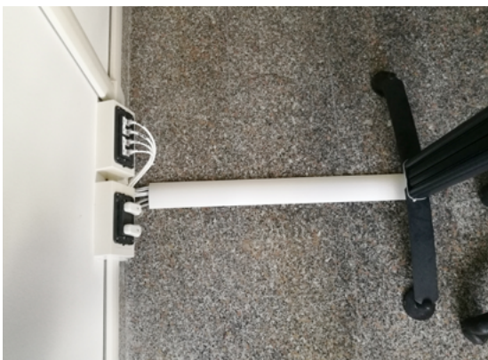
Zwischen Schreibtisch und Wand verlegte Kabelbrücke
